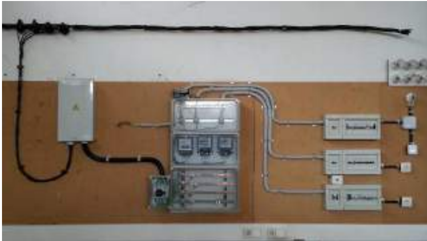
Instalación de enlace e interior de bloque de viviendas
